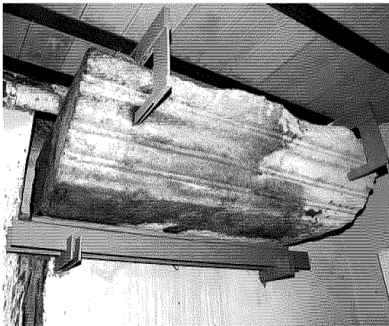
Una delle pietre del sito archeologico sui supporti installati durante il restauro
